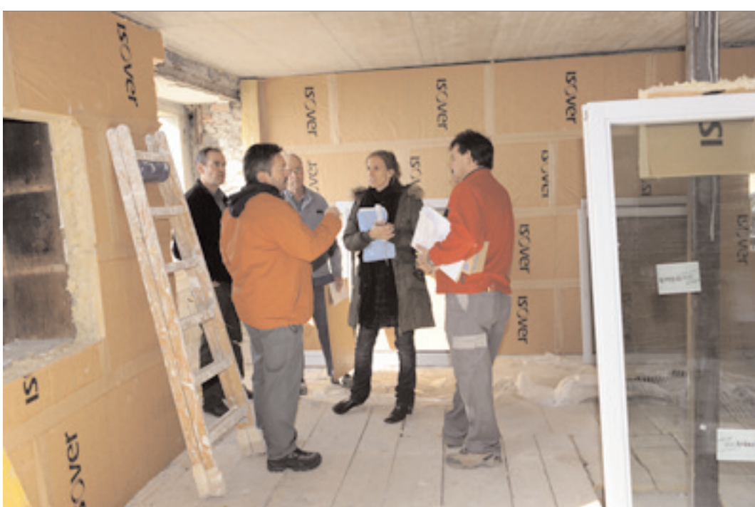
Séance de chantier avant les gros travaux à l'intérieur. Au centre, Yolande Delgado, architecte.
