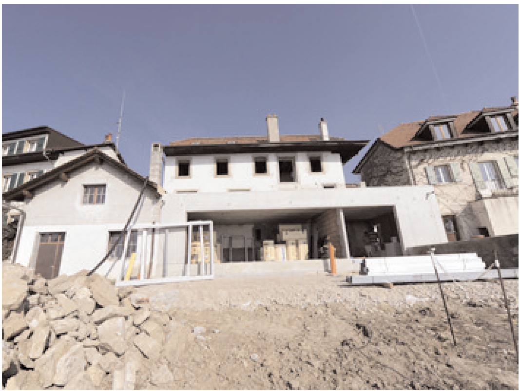
Le chantier a démarré: en bas, nouvelle annexe, en haut, une nouvelle grande fenêtre verticale.
